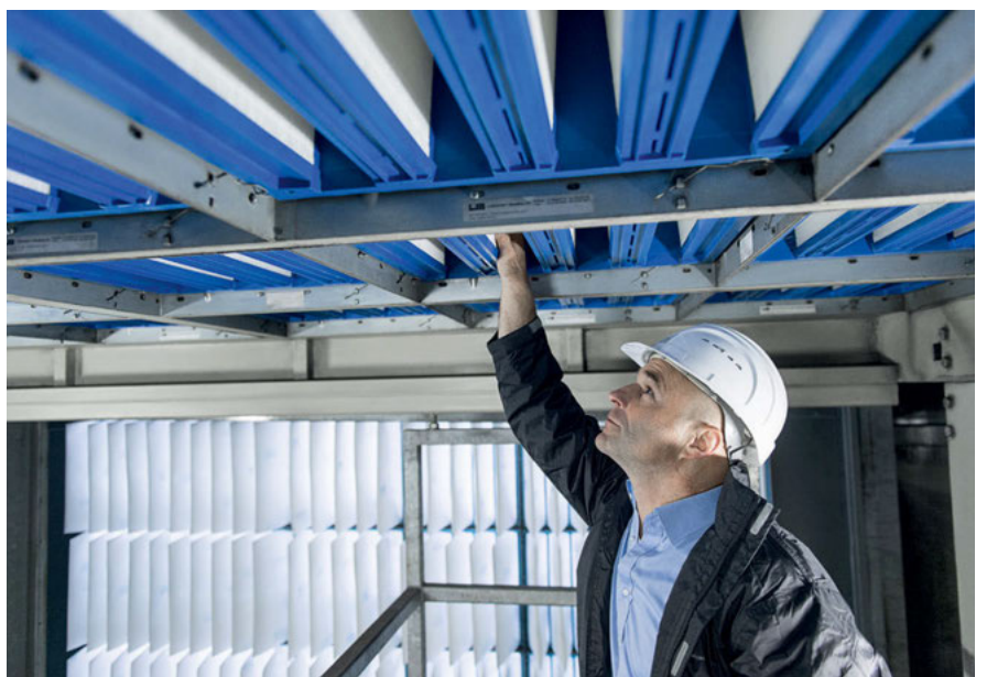
Zuluftfiltration in einem Kraftwerk Intake air filtration in a power plant
